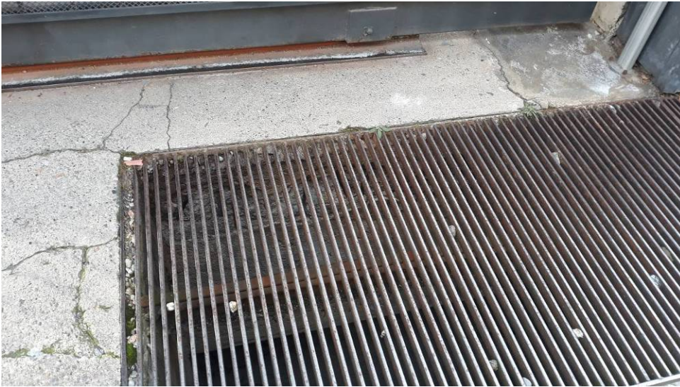
Fotografia 7 – In alcuni casi le travi in calcestruzzo armato a sostegno delle griglie sono deteriorate, con le barre di armatura scoperte e corrose
