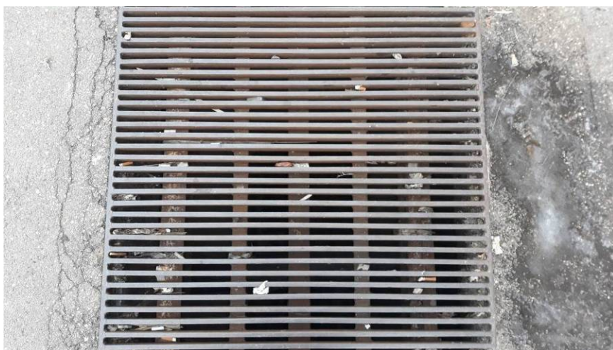
Fotografie 3,4 – Le griglie di fronte all'ingresso del supermercato sono rinforzate con diversi elementi trasversali
