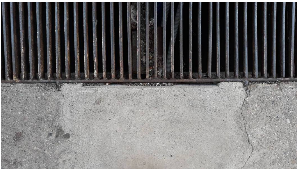
Fotografie 5,6 – Alcune griglie poggiano sulla struttura di contorno solo attraverso le piccole zanche presenti lungo il perimetro
